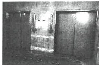
搬入用大型エレベーター
